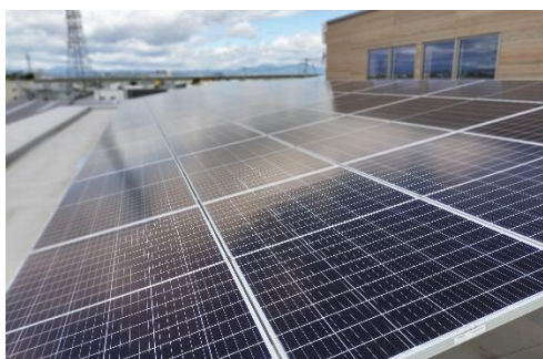
屋上の太陽光パネル
