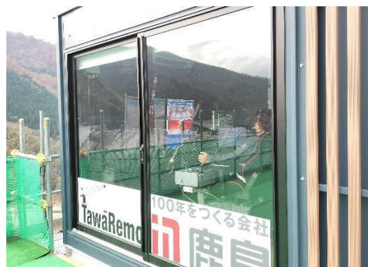
堤体上のクレーンの遠隔操作室
