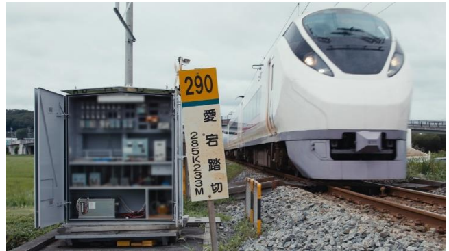
踏切保安装置のバックアップ電源
